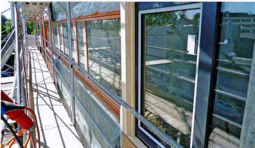
Die Baukoordination oblag einem Holzbauunternehmen – auch wenn von Holz von aussen nichts zu sehen ist
