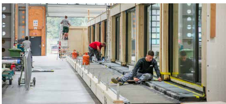
Vorgefertigt von der Photovoltaikanlage bis zum Parkett: Blick in die Produktion der Zimmermodule im Werk der Häring AG in Eiken.
